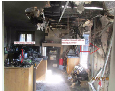
Photo extraite du rapport d'expertise sur l'incendie de Langoiran.
